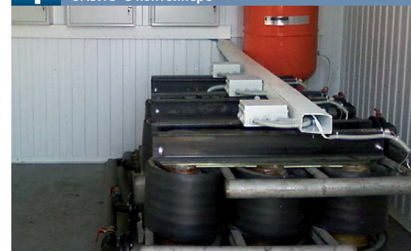
Рис. 7. Блок теплоснабжения «ОАЗИС» в контейнере
