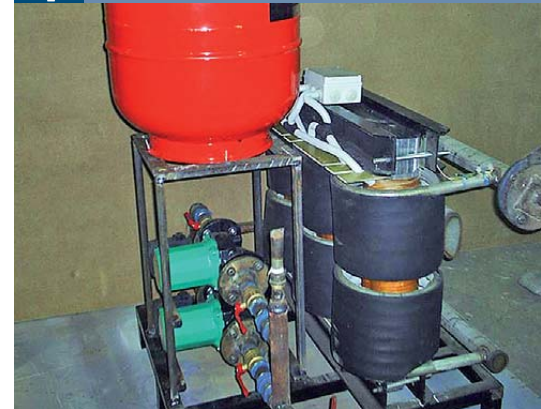
Рис. 6. Общий вид блока автономной системы теплоснабжения (БАСТ)
