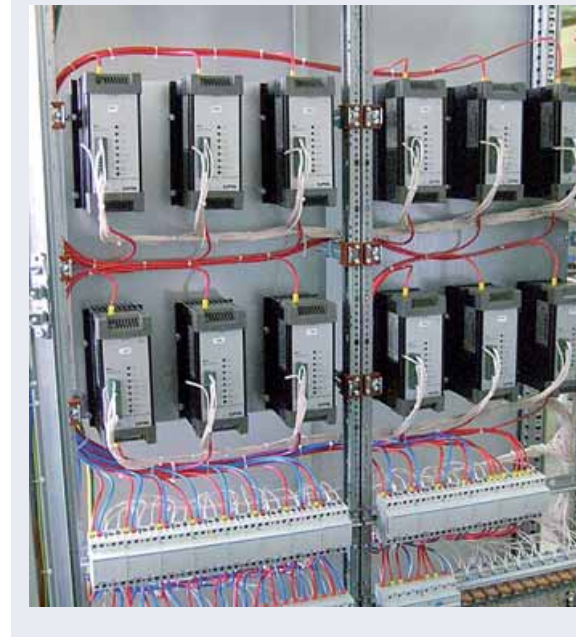
і Рис. 6 Силовой шкаф управления стеклопакетами атриума на гостинице Москва
