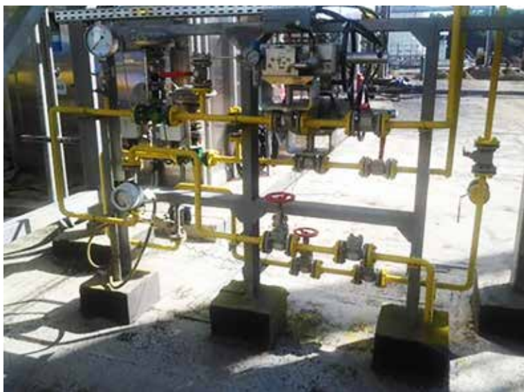
Фото участка обогреваемого трубопровода.
