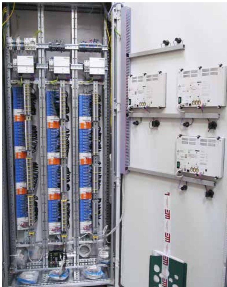
Рис. 1а. Шкаф управления для систем промышленного электрообогрева ТЕПЛОМАГ.
