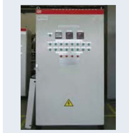
i Рис. 5. Типовой шкаф управления для системы ЛОНГЛАЙН
