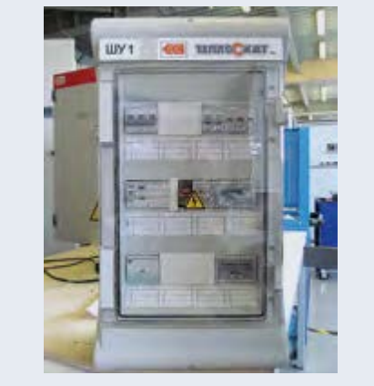
i Рис. 3. Шкаф управления для системы «Теплоскат»
