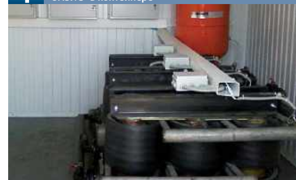
Рис. 7. Блок теплоснабжения «ОАЗИС» в контейнере
