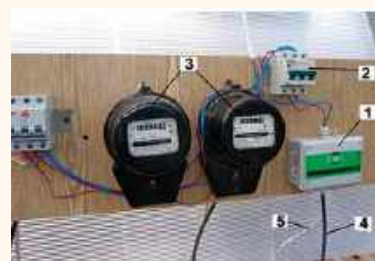
Рисунок 3 – Контролирующее оборудование после монтажа:
