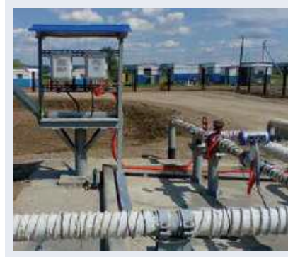
Нагрев нефтепроводов на ЦДНГ-10 УППН «Кокуй», Пермь, Лукойл
